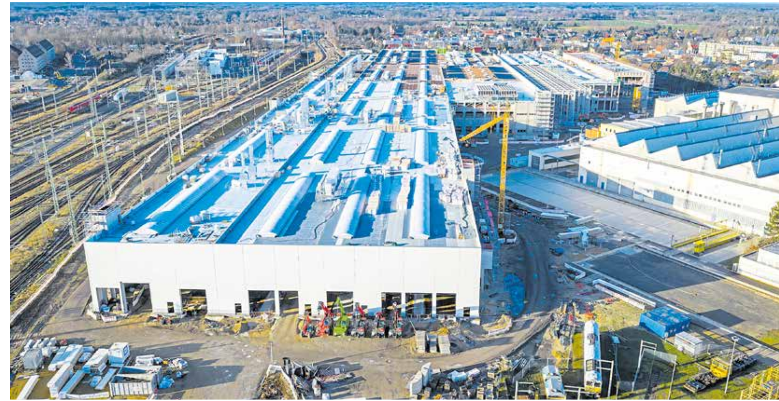
Die im Bau befindliche zweite Werkshalle (Halle 1) des neuen Bahnwerks misst über 500 Meter in der Länge und bis zu 200 Meter in der Breite. Sie umfasst drei Instandhaltungsgleise und ein Inbetriebsetzungsgleis, außerdem ein Lackiergleis, Komponentenwerkstätten, Einzelarbeitsstände sowie ein Materiallager. Foto: DB
