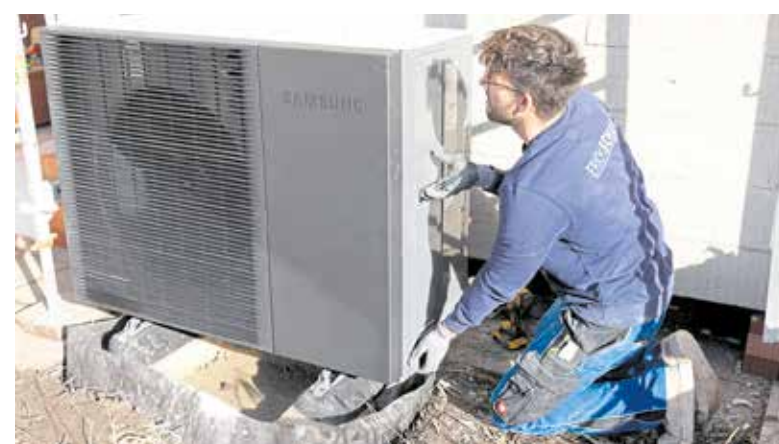
Wie viele Wärmepumpen werden künftig verbaut? Die Antwort auf diese Frage hängt mit der Förderkulisse zusammen. Foto: www.amh-online.de/Sascha Schneider
