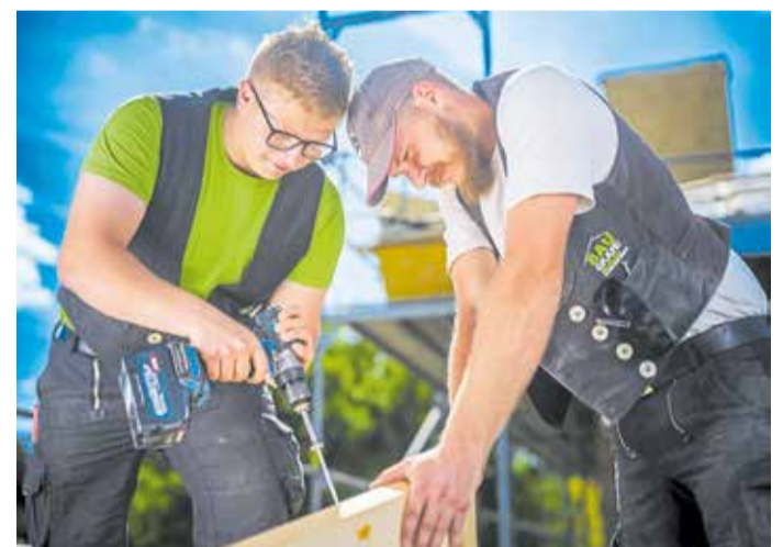
Vorarbeiter Richard Krahl und Zimmerer-Azubi Emilio von Wolfersdorff bei der Arbeit an einem Dachstuhl.
