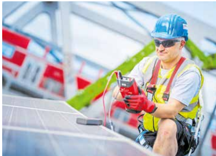
André Nestler überprüft die Solaranlage auf dem Dach des Stammhauses von TnT in Dresden.
